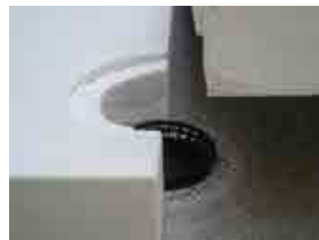
3. Postaviti odvajajući sloj, postaviti prsten za odvodnjavanje (HL180) na telo slivnika, postaviti toplotnu izolaciju
